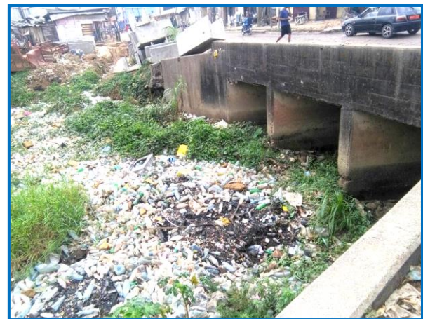
Photo 3.7 : Ordures sous un pont dans un quartier de Douala
